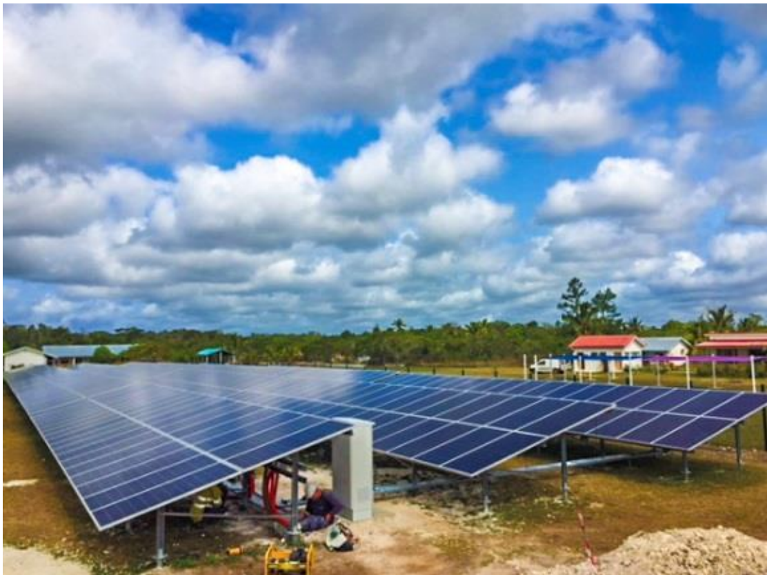
La centrale solaire de Hapetra
